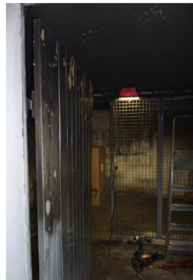
Die rußgeschwärzte Decken und Wände zogen sich bis ins Treppenhaus.
