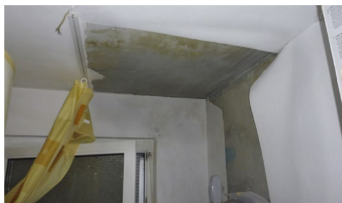
Abgelöste Tapeten, unter denen sich bereits Schimmel gebildet hatte, zeigten an manchen Stellen offensichtlich, wie weit die Feuchtigkeit sich durch das ganze Haus gezogen hatte.
