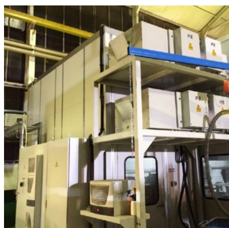
Unverrückbare Installationen erschwerten den Zugang zu verschmutzten Bereichen, sodass vieles nur mit Hubarbeitsbühnen erledigt werden konnte.
