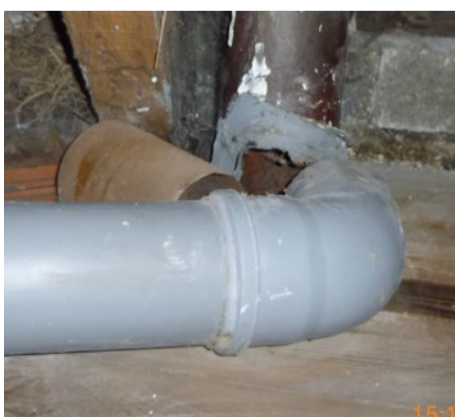
Was scheinbar harmlos aussieht, hat fatale Wirkungen entfaltet: Marode Rohre in Altbauten führen immer wieder zu schweren Wasserschäden.
