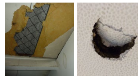
Beim Öffnen ausgesuchter Deckenpaneele zeigte sich schnell, dass der Ruß sich seinen Weg auch innerhalb der Decke gesucht hatte.
