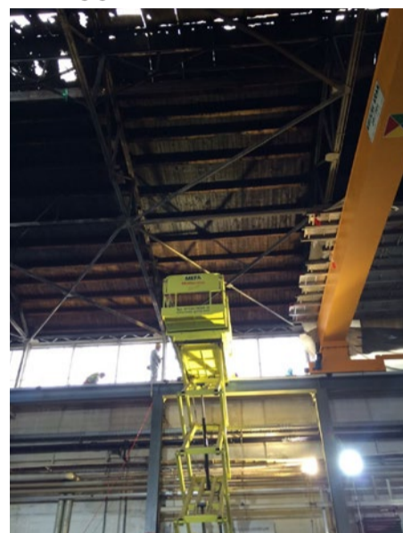
Durch die zusätzliche Nutzung des verfahrenbaren Hallenkrans als Grundgerüst für eine aus Dielen gelegte Arbeitsbühne konnten die Dacharbeiten erheblich beschleunigt werden.
